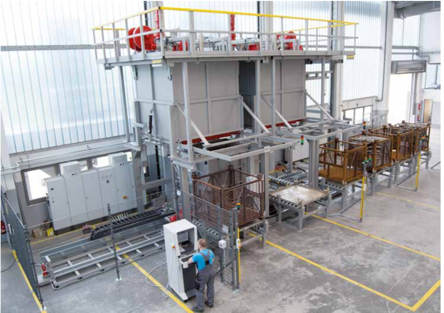
全自动式落底式炉设备，由2个落底式炉、可移动式水池和多个装料和卸料位组成
