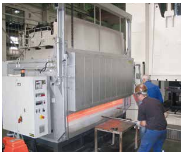
Horno de cámara N 1491/S en la producción
