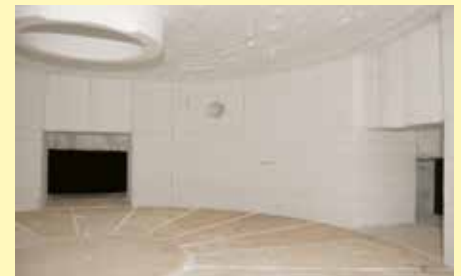
Mesa giratoria con placas de soporte de hormigón ignífugo para proteger el aislamiento
