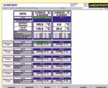
Vista general de la instalación
