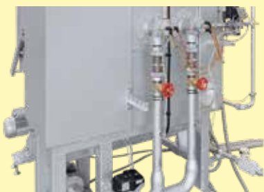
Tramo de gas con dos quemadores en la pared trasera del horno
