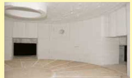
Drehtisch mit Auflageplatten aus feuerfestem Beton zum Schutz der Isolierung
