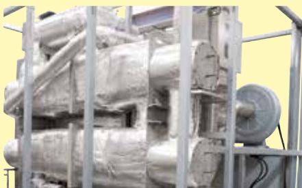
Gegenstrom-Wärmetauscher am Umluft-Kammerofen N 2560/26 ACLS
