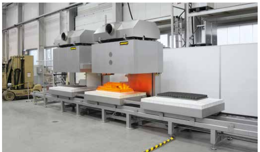
Automatische Vergüteanlage bestehend aus einem Haubenofen und zwei Kühlhauben zur forcierten Luftabkühlung (zweite Kühlhaube rechts nicht im Bild) mit Wechseltischsystem
