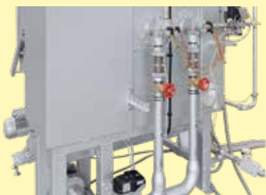
Gasstrecke mit zwei Brennern in der Ofenrückwand
