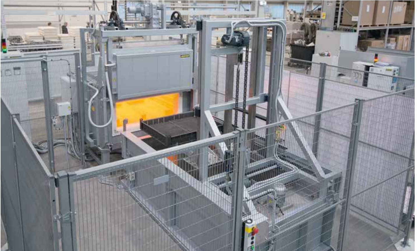
Vollautomatische Vergüteeinrichtung bestehend aus einem Glühofen, einem Wasserabschreckbad und einem zweiachsigen Manipulator
