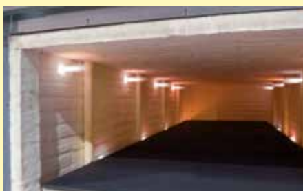
Cámara interna del horno con ocho quemadores de alta velocidad
