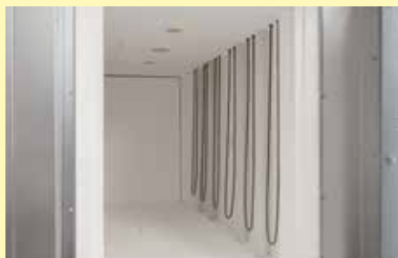
Introducción de aire precalentado mediante tubos cerámicos perforados
