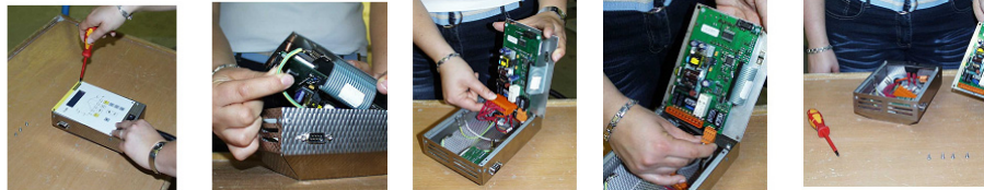
Abb. 28: Wechsel eines Controllers
